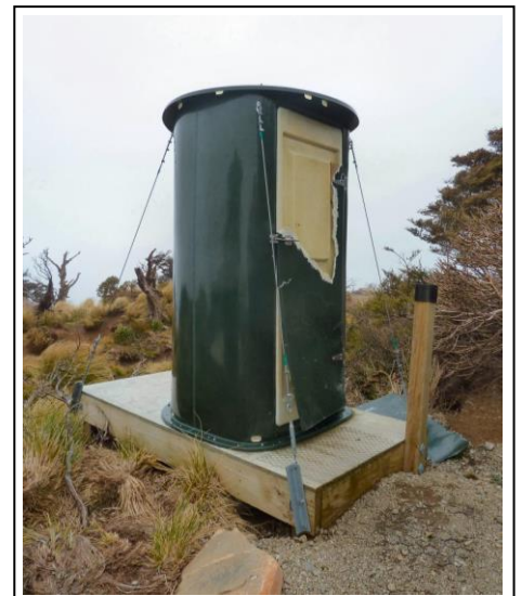
Wind damaged Sunrise toilet Alla
